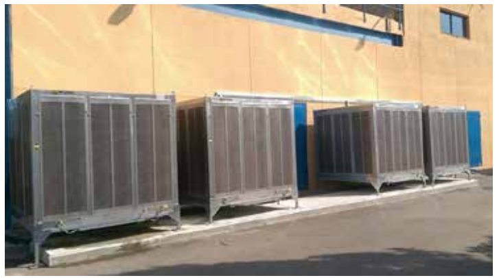
Instalación AD-55-H Inox en nave industrial de cogeneración
