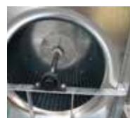
Grupo ventilador en acero galvanizado (con bastidor galvanizado en caliente) con tapas de protección del eje del ventilador.
